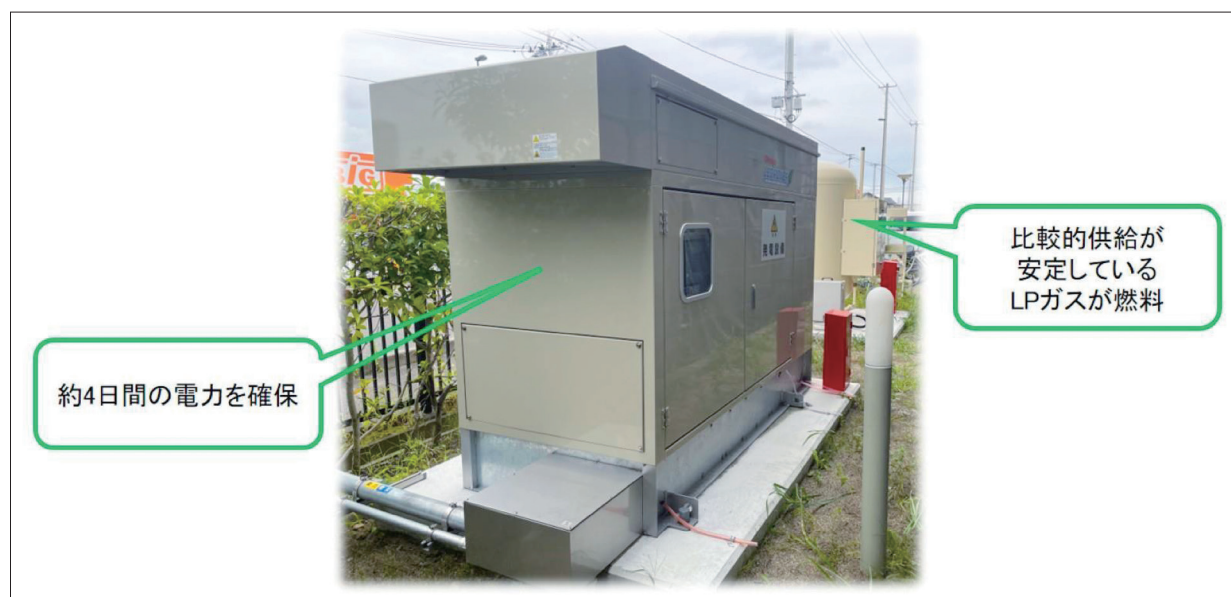
図1 非常用発電装置
